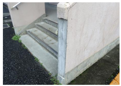
階段壁面の破損(平成30年度修繕予定)
