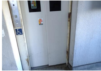
エレベーター入口の傷、サビ
