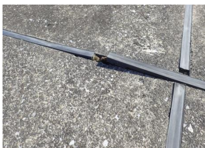
屋上の目地浮き
