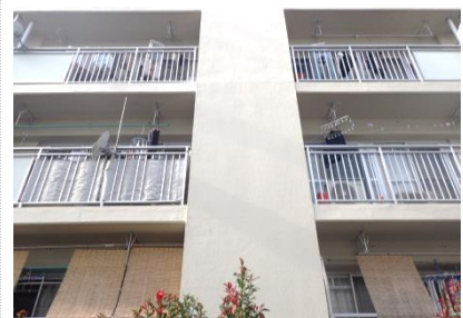
外壁のひび割れ(修繕済み)
