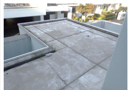
屋上のひび割れ
