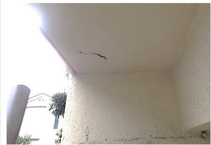
ベランダ天井の鉄筋露出
