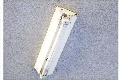
蛍光灯の塗装剥がれ
