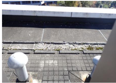
屋上床の破損
