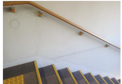
階段壁面のひび割れ(各階にあり)
