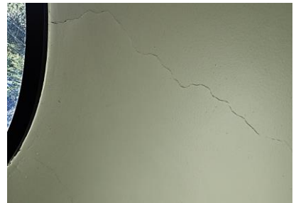
階段壁面のひび割れ
