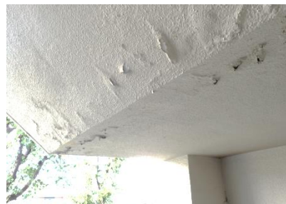
階段天井の塗装剥がれ
