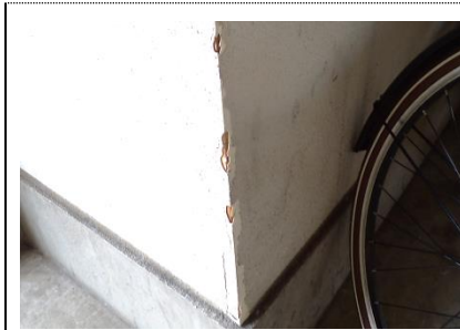
エントランス柱の破損
