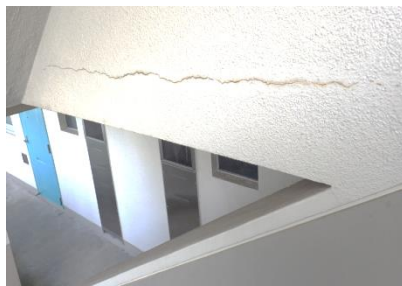
階段壁のひび割れ
