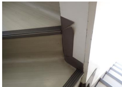
階段幅木の剥がれ
