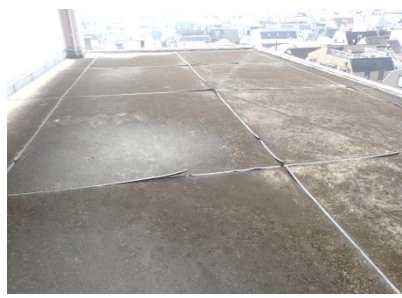
屋上の目地浮き(平成30年度修繕予定)
