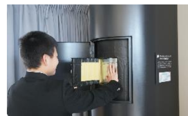
クールヒートレンヂダクトに触れる事で温度差を実感できる
