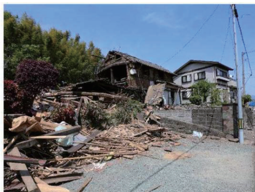
旧耐震基準（写真左）と新耐震基準（写真右）の住宅被害の相違
